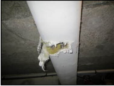
Photo N° 634 ECH-N°2 CALORIFUGEAGE --SOUS SOL Conduits de fluide Laine minérale + enveloppe plâtrée
